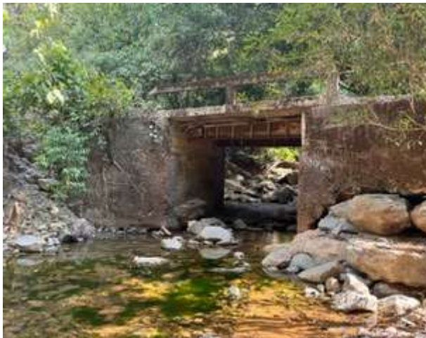
Fotografía 70. Afectación por Huracán Julia
