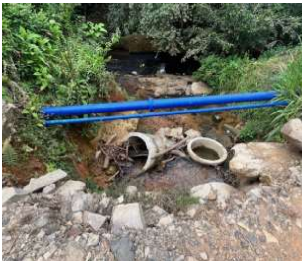
Fotografía 72. Afectación por Huracán Julia
